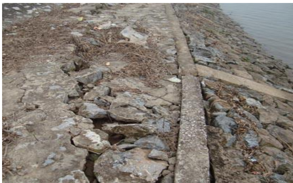
Рисунок 3.8. Нарушения устойчивости внешнего откоса дамбы за счёт быстрой сработки уровня паводковых вод (Фото Динь Т.Х.)
